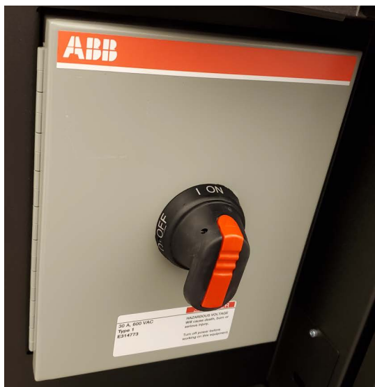
Figure 1 : Disjoncteur principal en position ON
