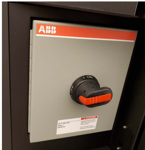
Figure 5 : Disjoncteur principal OFF
